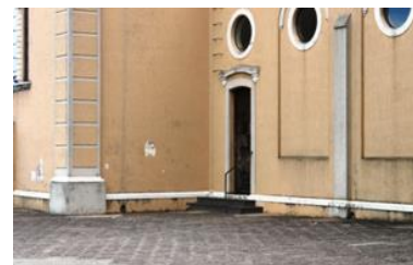
Figura 11 – Ausência de sinalização tátil e rampa de acesso ao edifício. Fonte: Autor, (2015).
