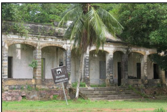
Figura 7 – Ruínas do edifício
